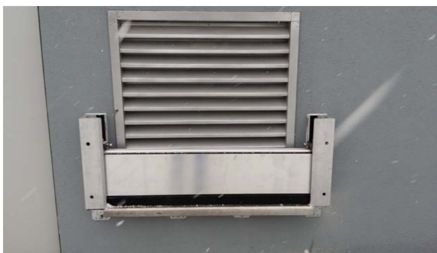
📍 Białystok 📄 Zabezpieczenie trafostacji galerii handlowej przed gwałtownymi ulewami 📏 0,3 m
