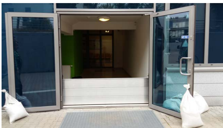
📍 Poznań Zabezpieczenie przeciwpowodziowe wejścia budynku AWF w Poznaniu 📏 0,6 m
